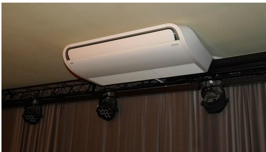
Rys. 26 Klimatyzator w dworze Hupki
